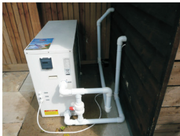
Separata ventiler för IN-kommande och UT-gående vatten saknas
