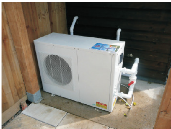
Aggregatet är placerat för nära väggen
